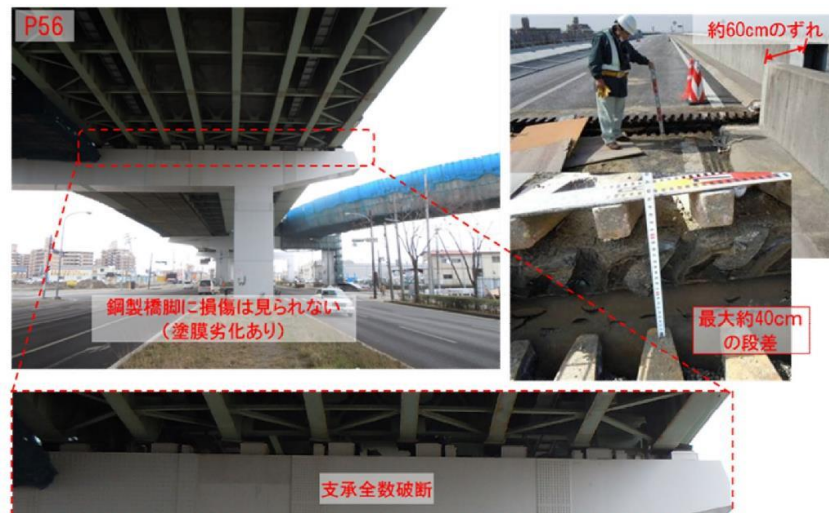
写真 2.1.36 P56 (I 桁側) 支承部及び路面の被災概況 (参考：土木学会 鋼構造委員会「東日本大震災鋼構造物調査特別委員会報告書」)
